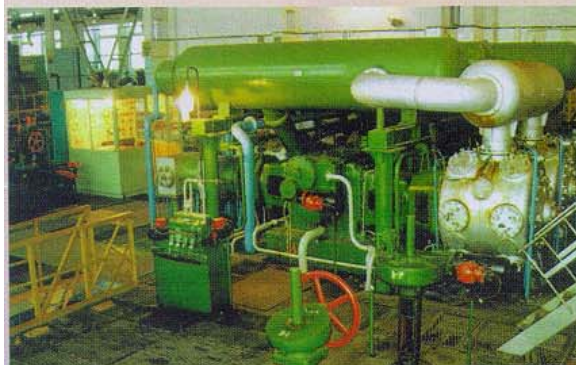
Компрессорная водородная установка Compressor-hydrogen facility
